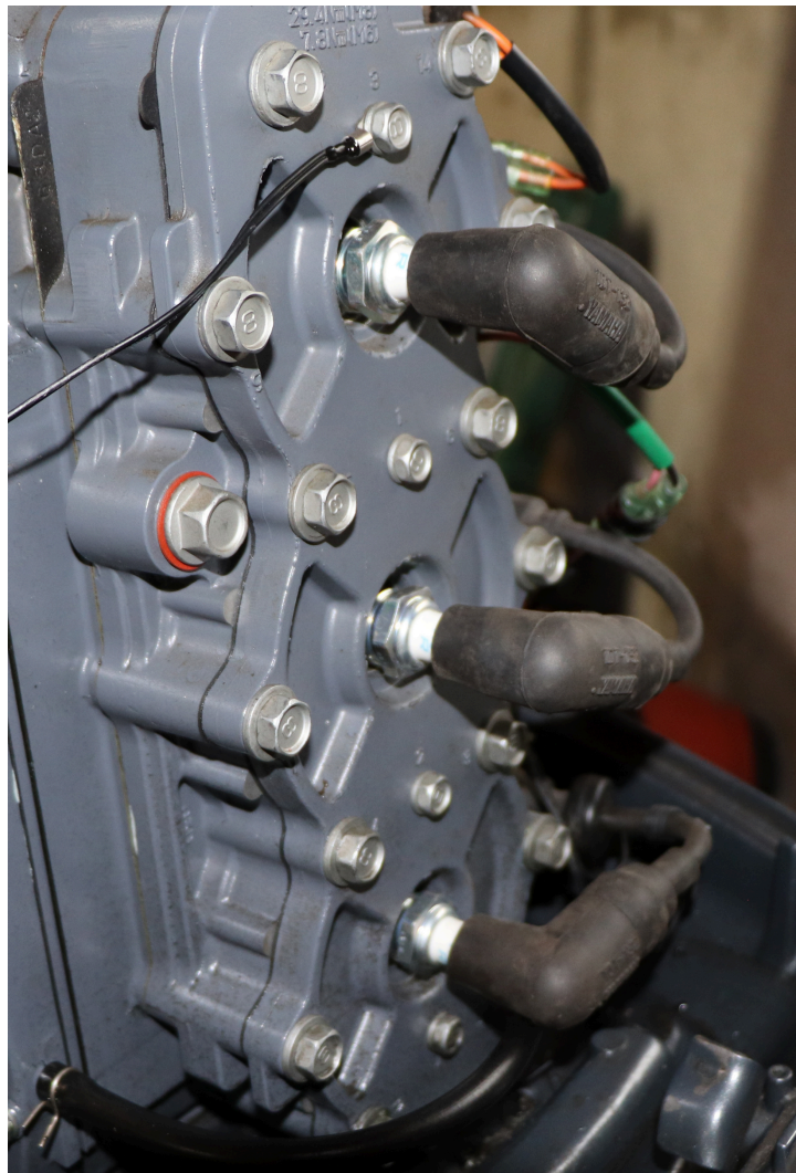
Пример установки датчика температуры.
